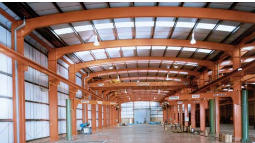
Afb. 2.8 Gebogen dakspanten gebruikt bij portalen.
