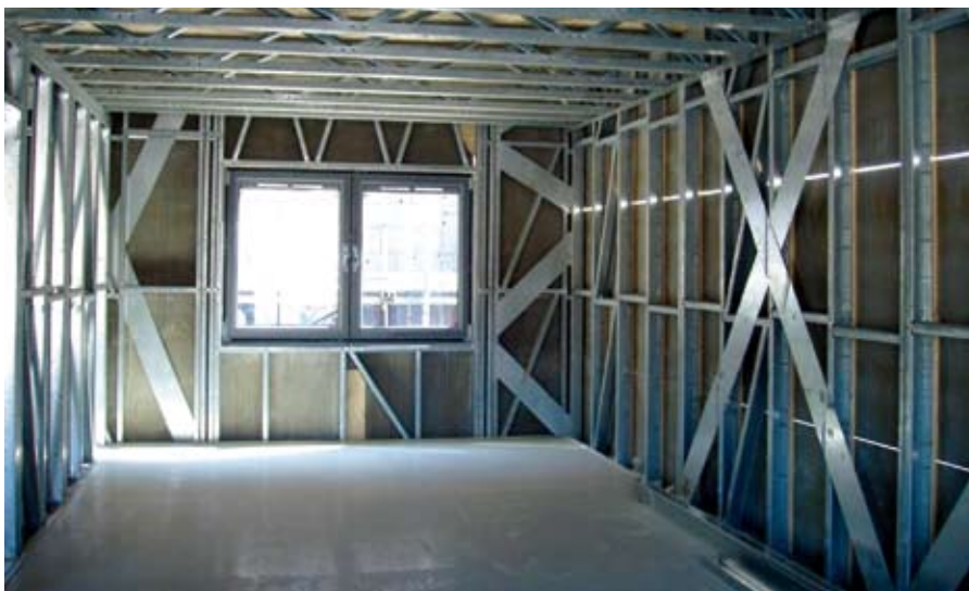
Afb. 3.3 Bij grote overspanningen zijn in staalframe vloeren ook vakwerkliggers toe te passen die uit koudgevormde profielen zijn samengesteld. Bron: Metek Building Systems.
