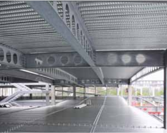
Fig.3: ACB-liggers voor de structuur van de parking Fig.3: Poutres ACB pour la structure du parking
